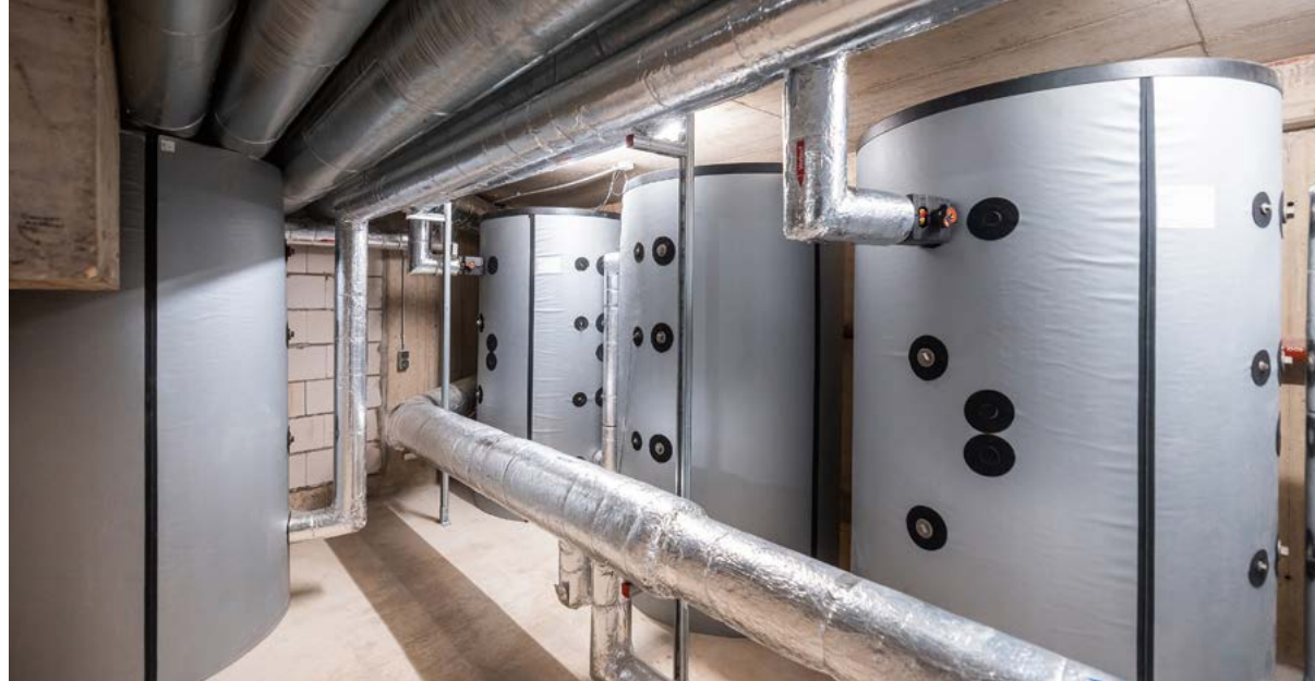
Pufferspeicher einer Pelletheizung
